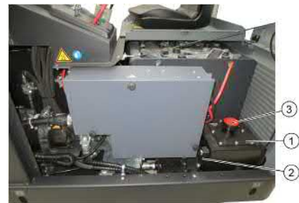
1 Depósito do óleo hidráulico
